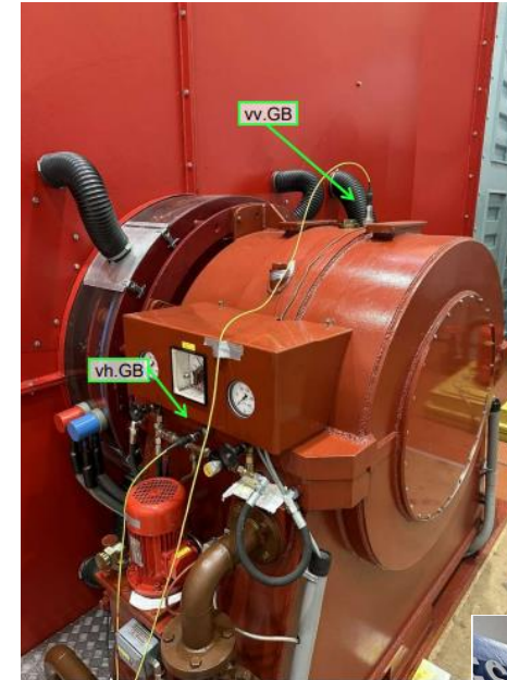
Abb. 4: Sensoren am Generatorlager Erregerseitig
