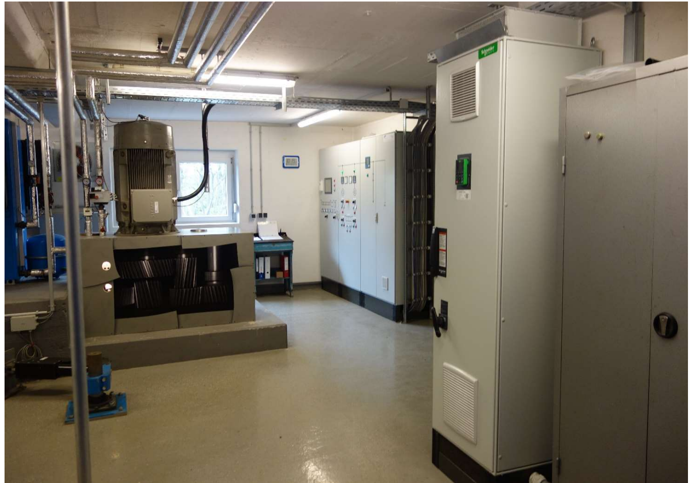
Abbildung 8: 90 kW Generator mit Frequenzumrichter von Fa. Schneider Electric
